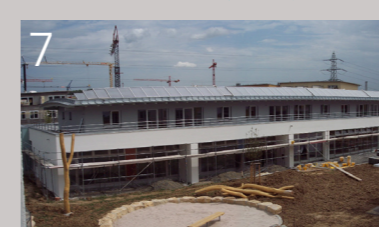
Nahwärmenetz Holzgerlingen (249 m 2 )
