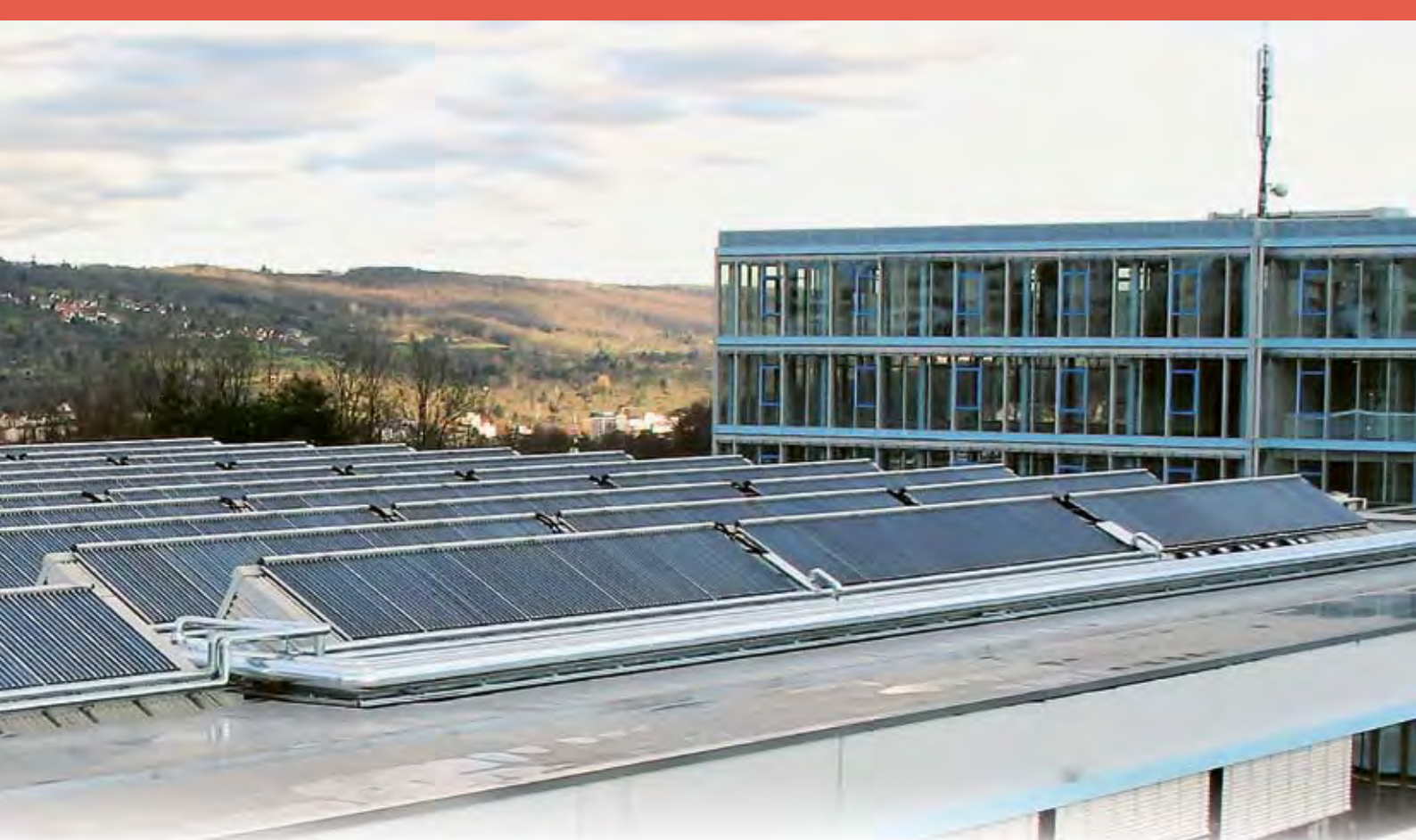
Kollektorfeld der solarunterstützten Klimatisierung der Festo AG & Co. KG in Esslingen, Fotos und Grafiken: Hochschule Offenburg
