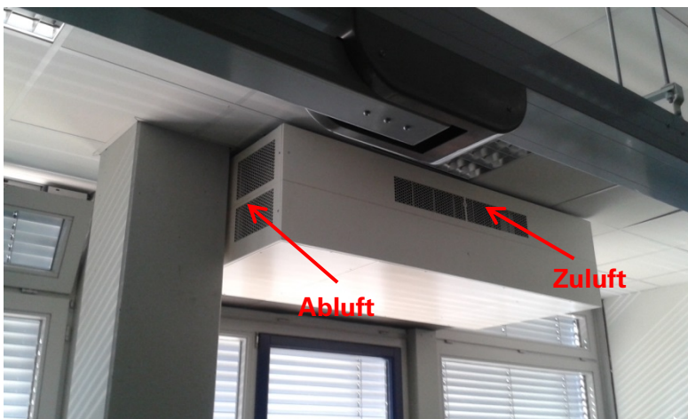
Abb. 3.2: Deckenlüftungsgerät bei dem Zuglufterscheinungen auftreten
