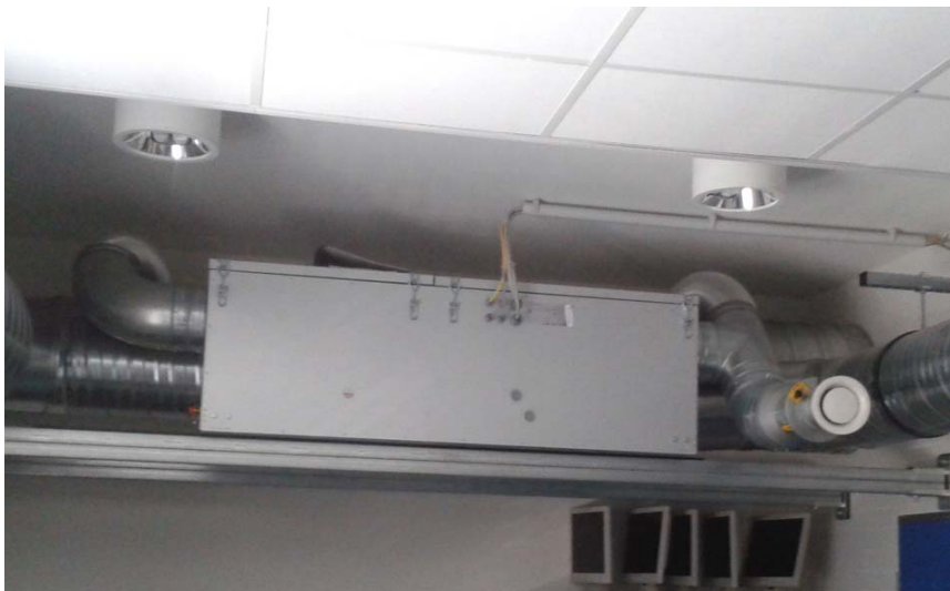
Abb. 3.3: Deckenlüftungsgerät mit zusätzlicher Verrohrung für Zu- und Abluft.
