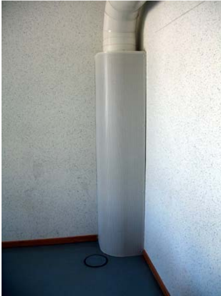
Abb. 3.1: Quellauslass im Computerraum einer untersuchten Schule
