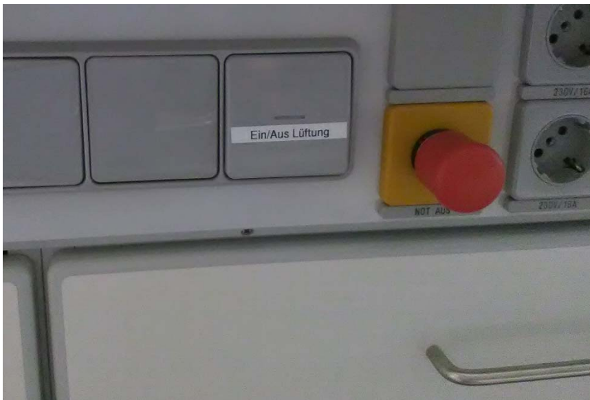
Abb. 2.2: Taster am Lehrerpult zur temporären Deaktivierung des Lüftungsgerätes
