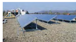
Altherme Waldbronn (Kollektorfläche: 226 m 2 )
