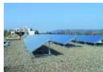
Albtherme Waldbronn (Kollektorfläche: 234 m 2 )
