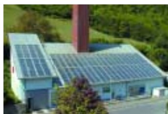
Hegau Klinikum Singen (Kollektorfläche: 264 m 2 )
