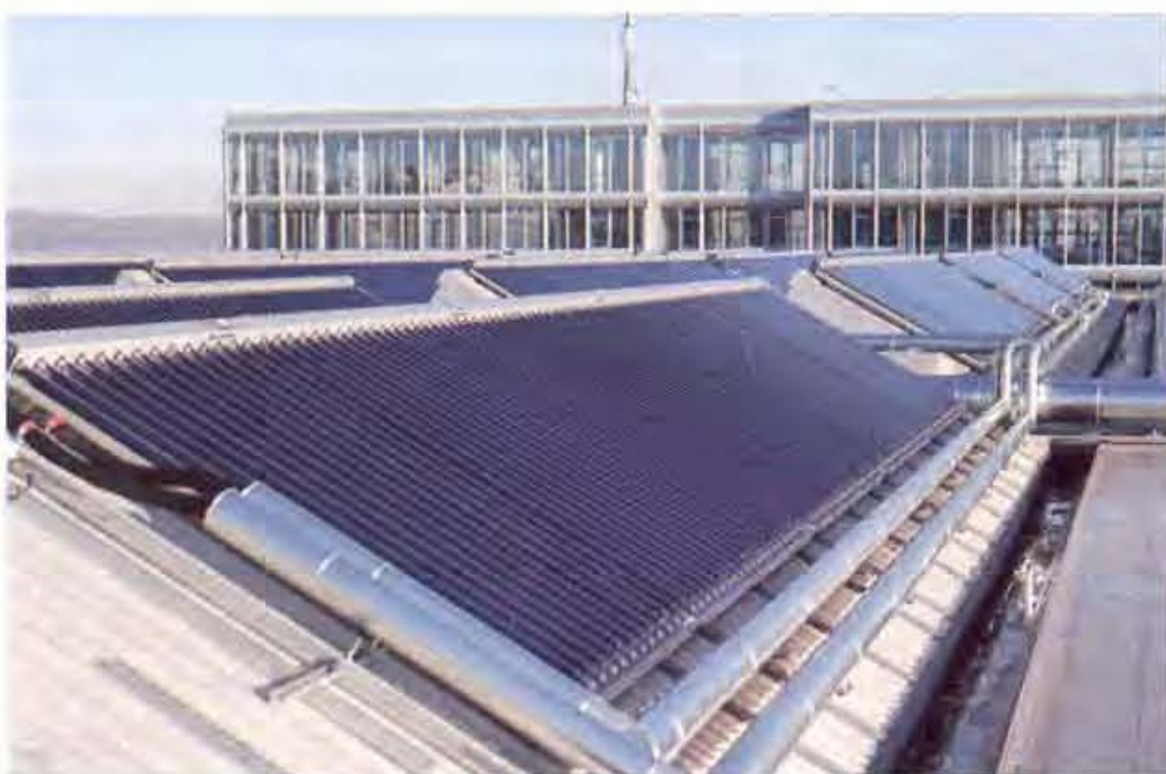
Abb. 1: Teil des Kollektorfeldes und des Nachbargebäudes, das mit Solarwärme und -kälte versorgt wird. (Quelle: Festo)
