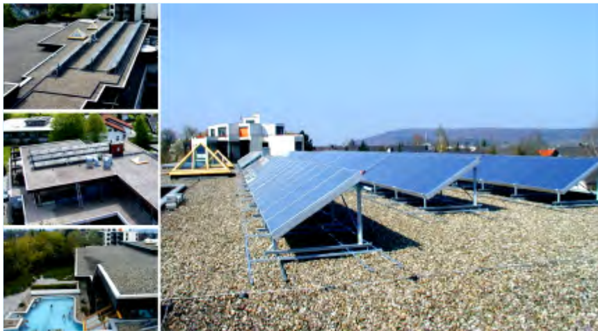
Abb. 1: Gebäude und Kollektorfeld der albtherme Waldbronn
