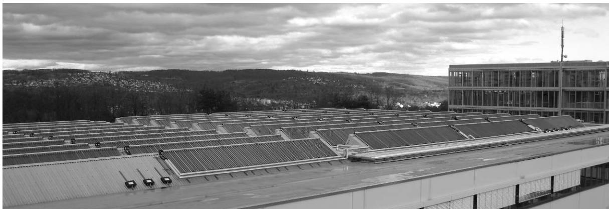
Abb. 1: Kollektorfeld der solarunterstützten Klimatisierung der Festo AG & Co. KG in Esslingen
