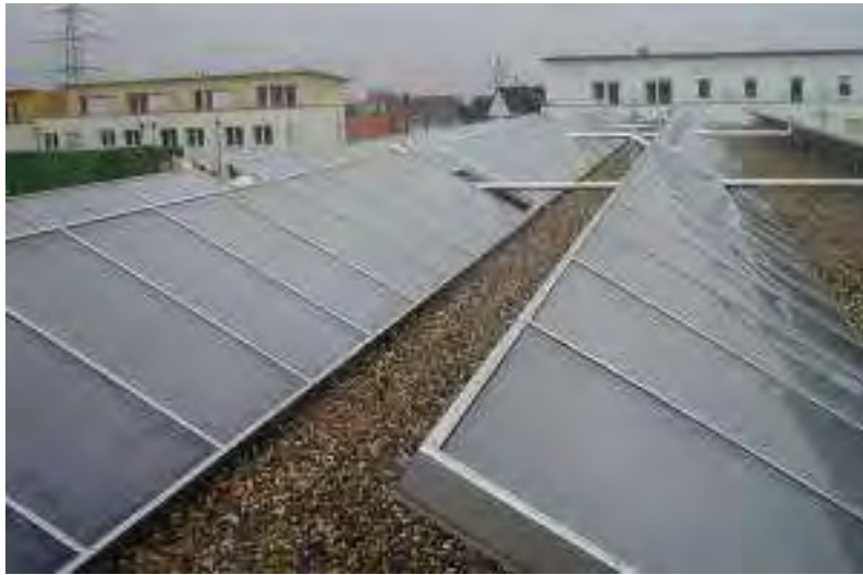
Bild 8: Kollektorfeld auf dem Dach des Kindergartens
