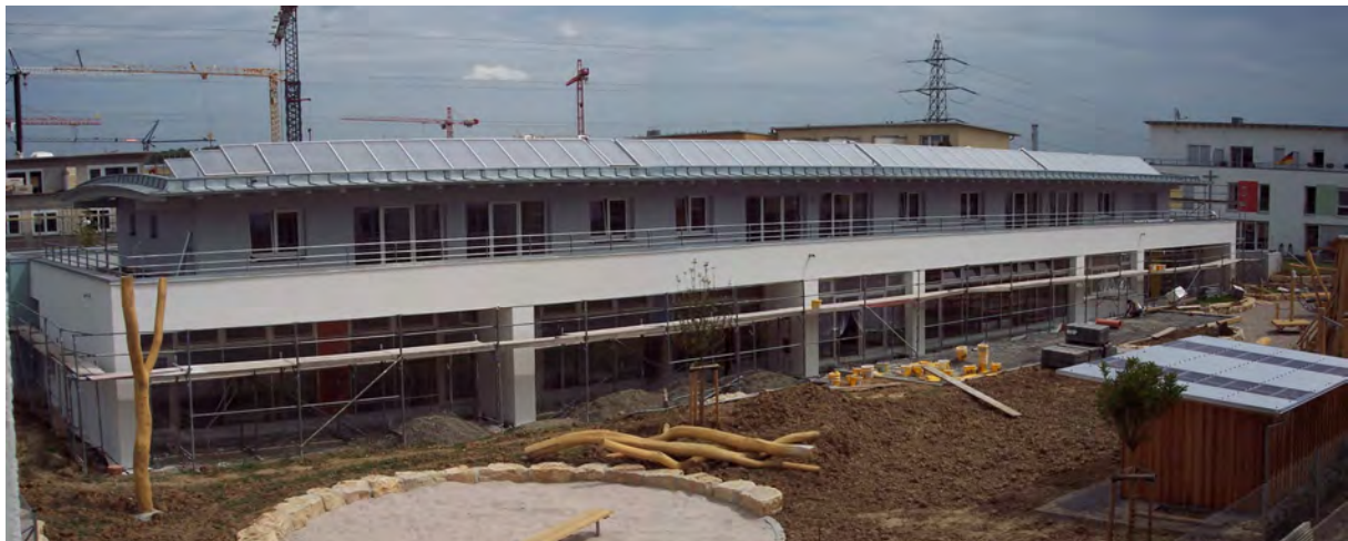
Bild 1: Ansicht des Kollektorfeldes auf dem Kinderhaus
